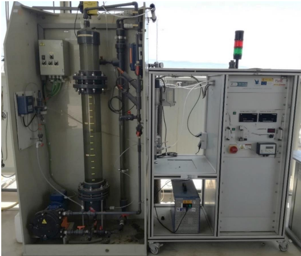
Figura 3.26 - Planta piloto de ozonización ubicada en las instalaciones del Laboratorio de Tratamientos Solares de Agua de la PSA.
