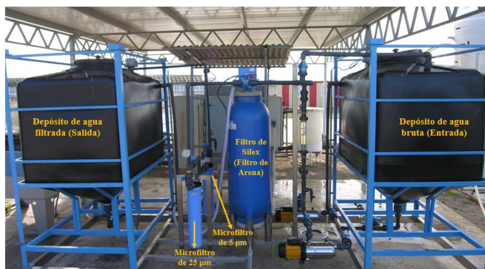
Figura 3.21 - Unidad de filtrado de efluentes: filtro de arena y microfiltros de 25 y 5 µm.
